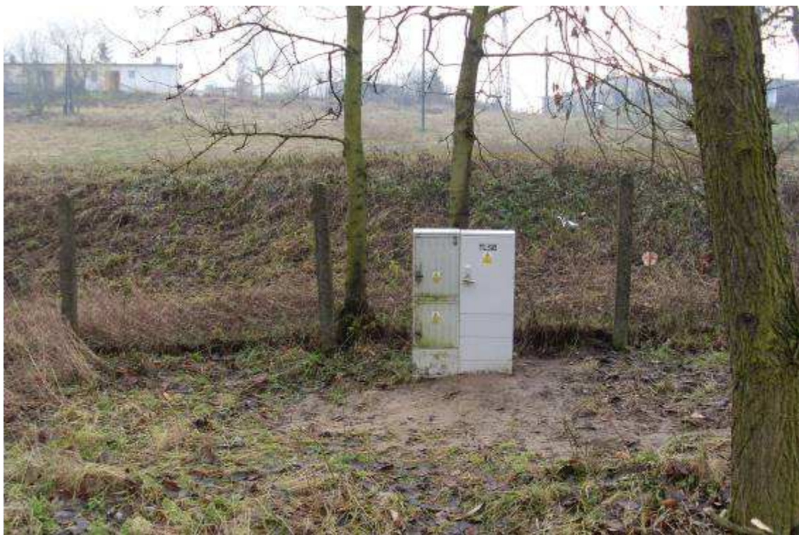
Fot. 74. Szafka oświetleniowa – oświetlenia drogowego w miejscowości Strzelewo
