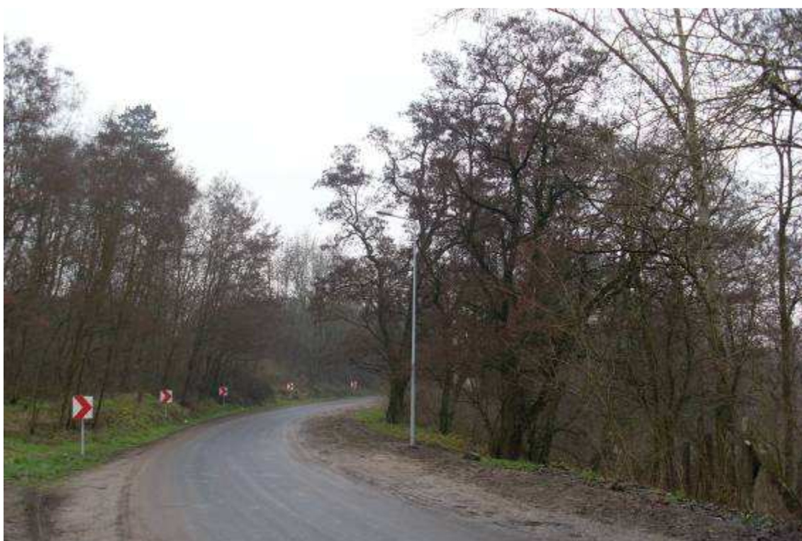
Fot. 75. Oświetlenie drogowo w miejscowości Strzelewo
