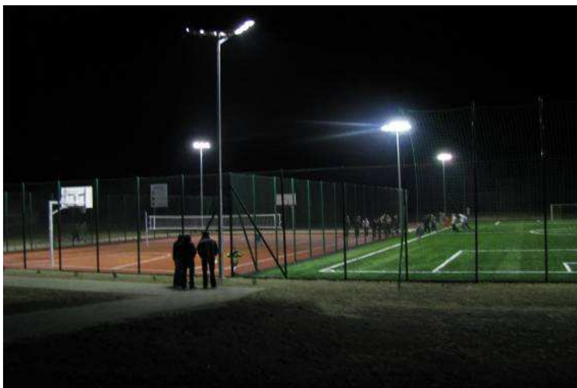
Fot. 58. Oświetlenie boiska
