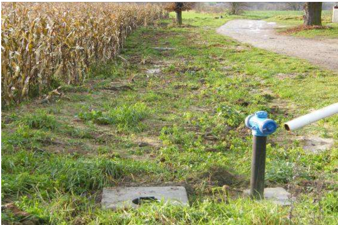
Fot. 15. Sieć wodociągowa (hydrant przeciwpożarowy na nowym odcinku sieci)
