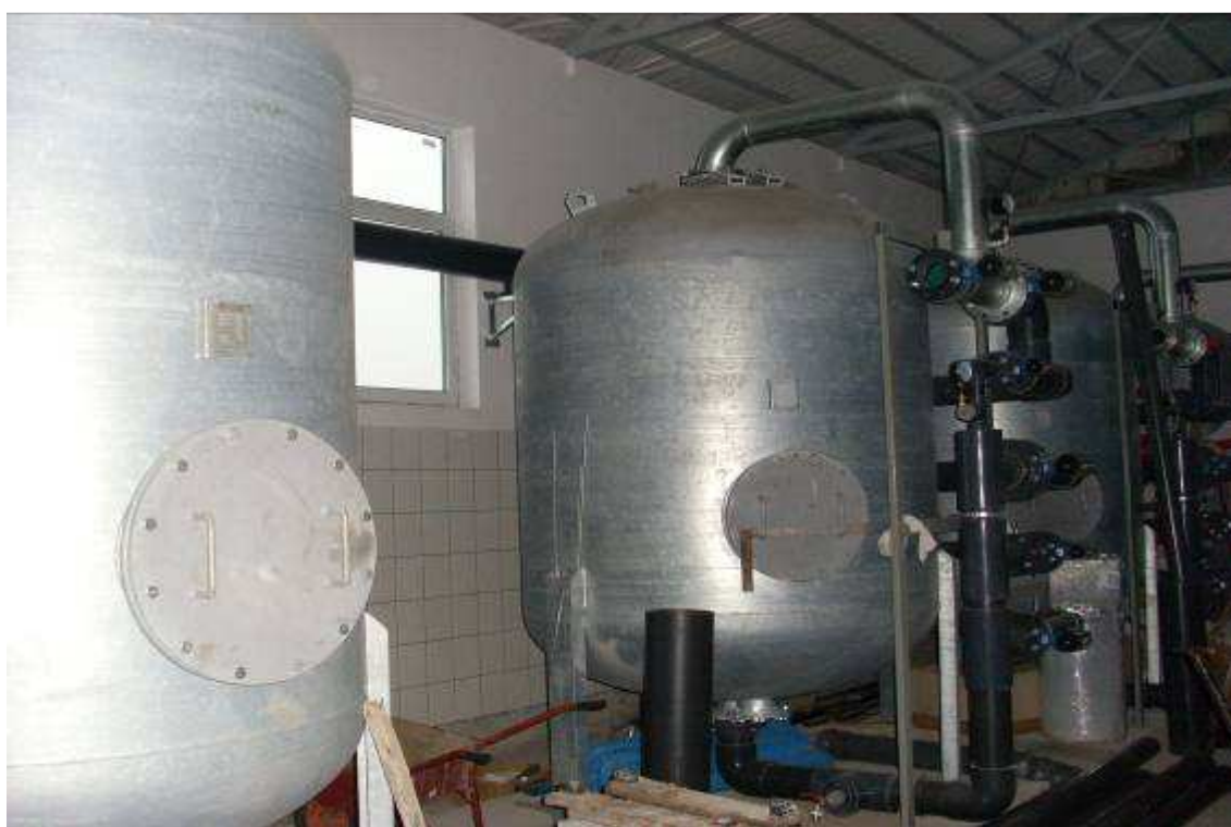
Fot. 6. Zbiorniki i aparatura uzdatniania wody
