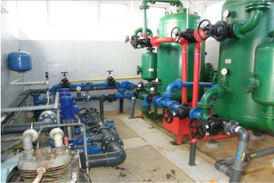
Fot. 18. Rurociągi i armatura w SUW Kruszyn
