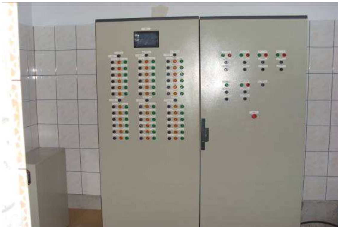
Fot. 5. Szafa rozdzielcza w stacji uzdatniania wody
