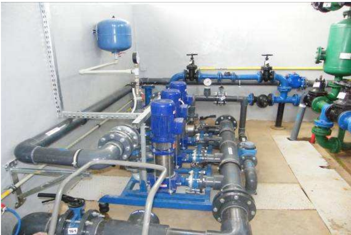
Fot. 19. Rurociągi i armatura w SUW Kruszyn
